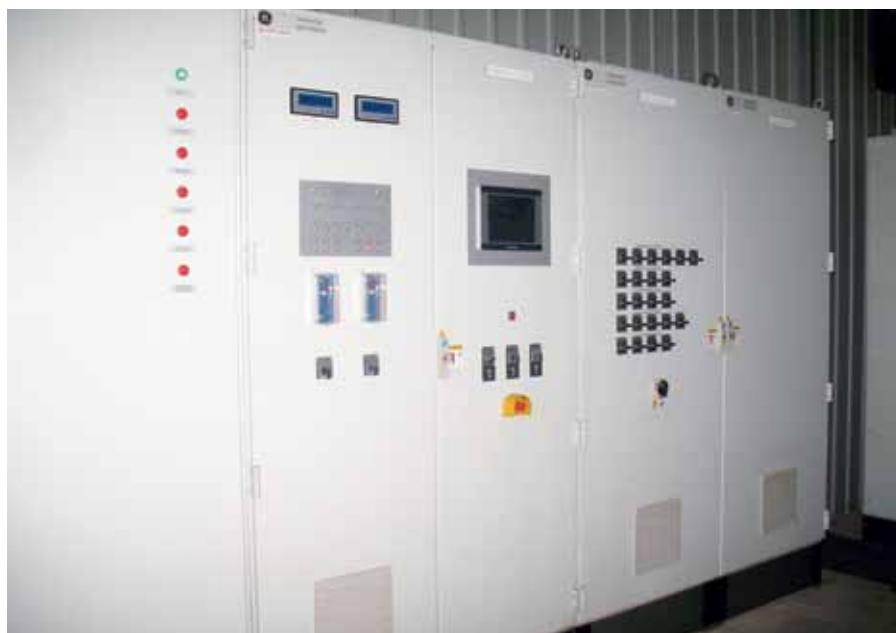
Рис. 1. АСУЭ PDCS101 энергокомплекса на базе газопоршневых установок
