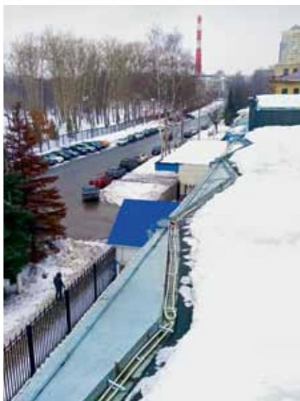
Рис. 3. Система «Ледовый патруль» на крыше офисного здания компании «ССТЭнергомонтаж»
