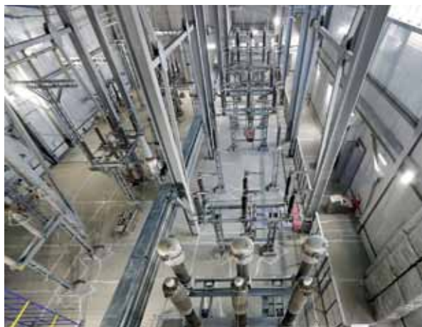
Рис. 2. Помещение ЗРУ 110 кВ
