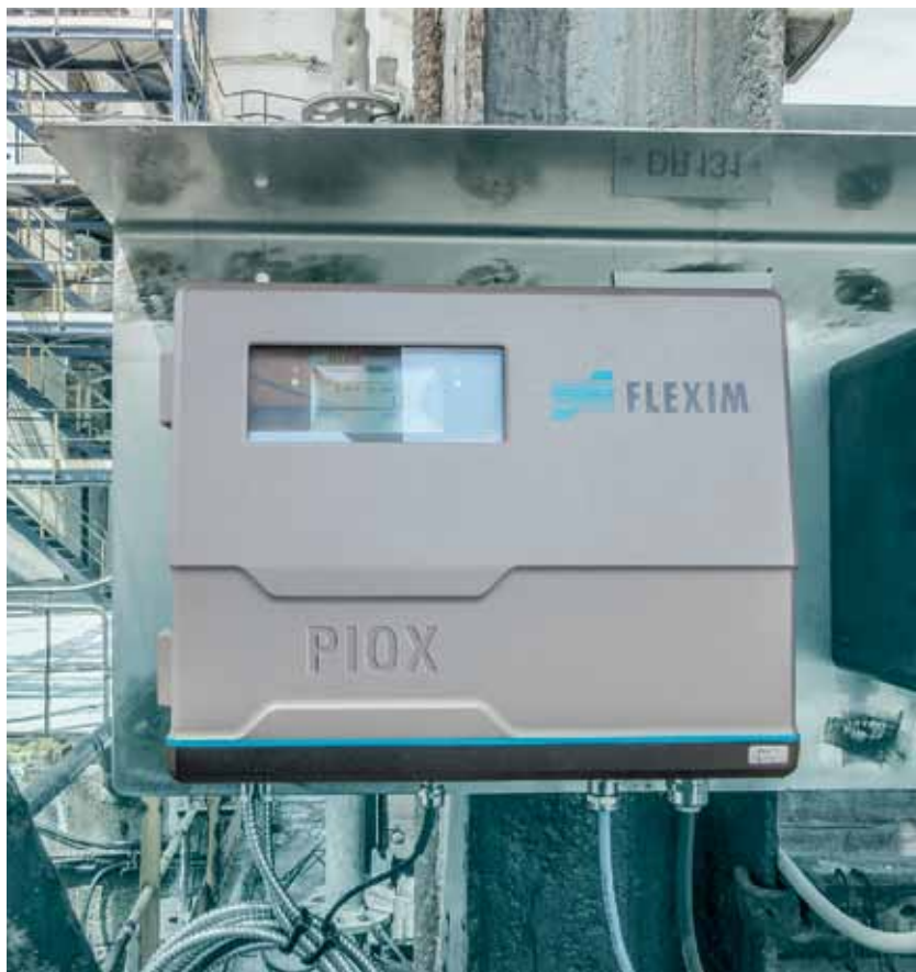
Рис. 2. Концентратомер P10X S, установленный на промышленном объекте
