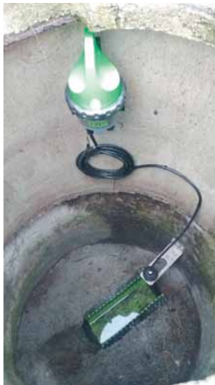
Рис. 2. Расходомер LT-US, установленный на объекте
