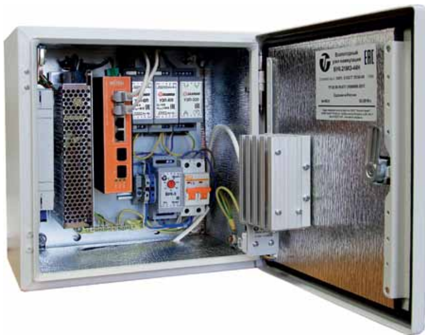
Рис. 1. УЗИП в составе термошкафа
