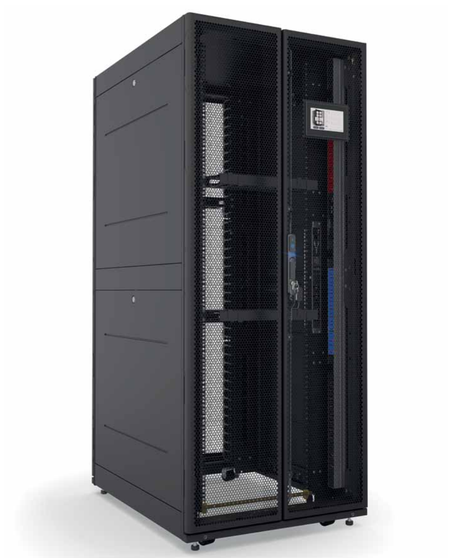
Рис. 4. Серверный шкаф ЦМО с установленной мини-СКУД на основе интеллектуальной PDU
