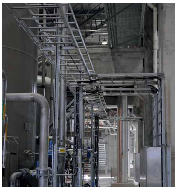
Рис. 2. Кабельная трасса МЕКА на базе лотков KS80 на промышленном предприятии
