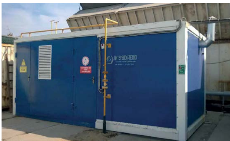
Рис. 2. Производственная БМК ИНТЕРБЛОК
