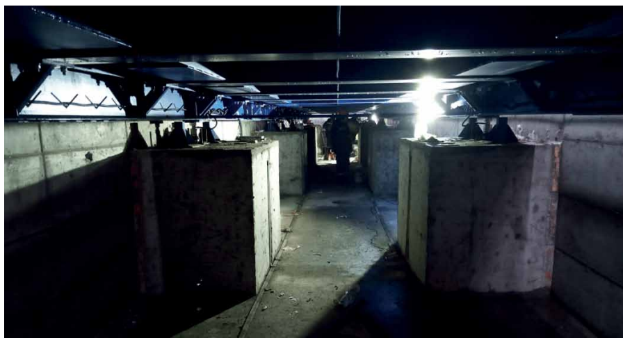
Рис. 3. Прямок под весами для проведения обслуживания и ремонта
