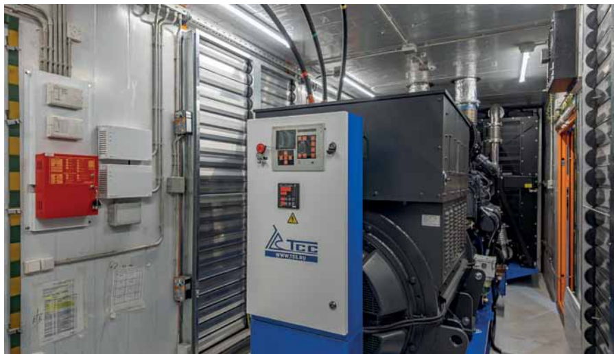
Рис. 1. Дизельная электростанция ТСС с системой управления, сигнализации и защиты
