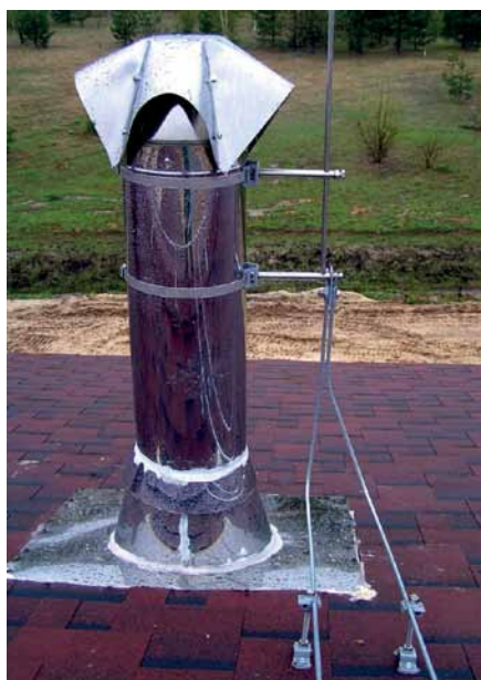
Рис. 5. Молниезащита вентиляционной трубы
