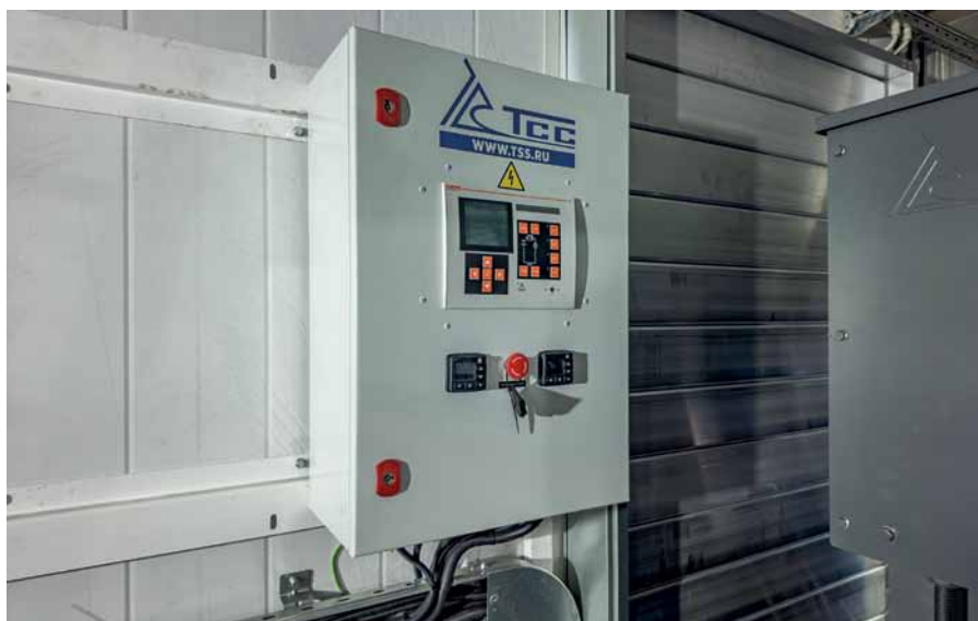
Рис. 3. Шкаф управления ДГУ с контроллером Lovato
