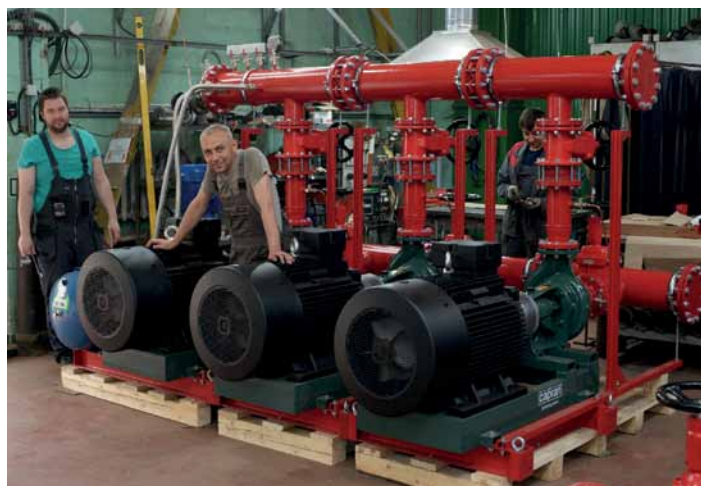
Рис. 5. Станция пожаротушения, изготовленная для военного объекта
