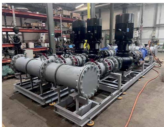
Рис. 2. Насосная станция на заводе «Ростсельмаш», г. Ростов-на-Дону: имеет коллекторы диаметром 400 мм
