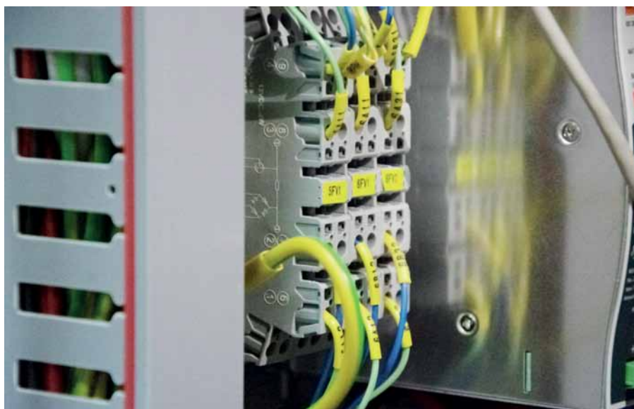
Рис. 4. Установленное в оборудование УЗИП
