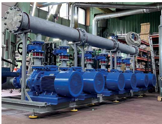
Рис. 1. Шестинасосная станция мощностью 270 кВт на заводе мясной продукции
