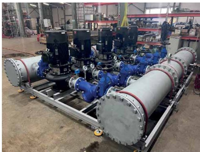
Рис. 4. Насосная станция, установленная в Детском клиническом центре им. Л. М. Рошаля в г. Красногорске Московской обл.
