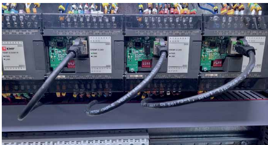
Рис. 3. Оборудование систем удаленного управления и мониторинга отопления и вентиляции в офисном комплексе
