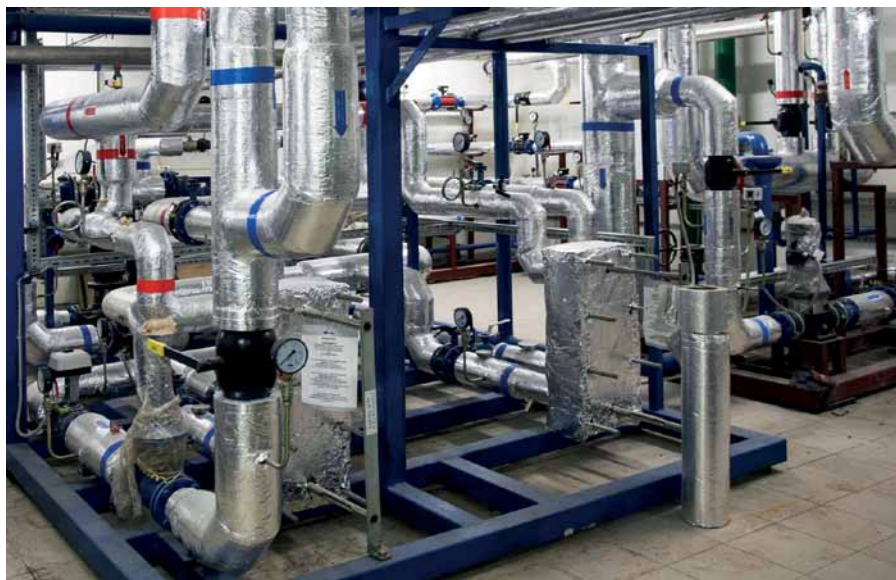
Рис. 1. Блочный тепловой пункт
