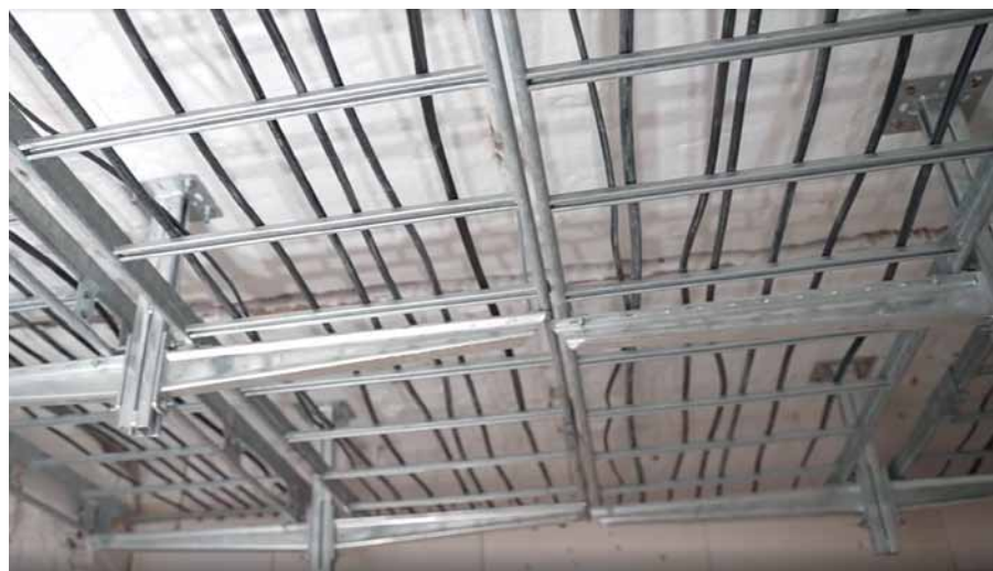
Рис. 5. Пример установки КНС в составе огнестойкой кабельной линии на объекте
