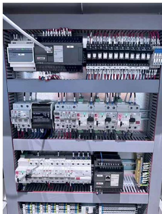
Рис. 5. Щит автоматизированной системы мониторинга
