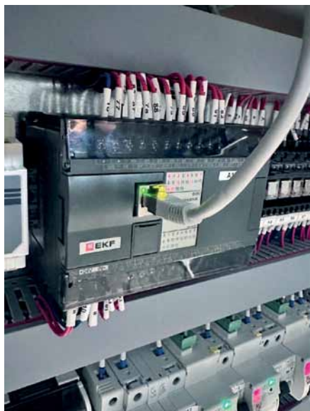
Рис. 1. Щит автоматизированной системы мониторинга энергоснабжения и энергораспределения в торговом порту
