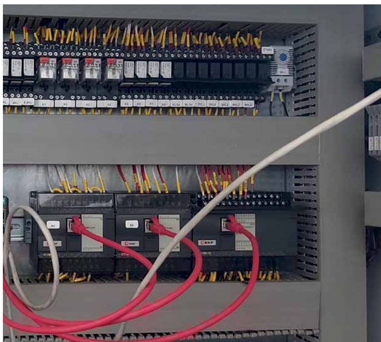
Рис. 4. Щит управления автоматизированными конвейерными линиями производства и розлива подсолнечного масла
