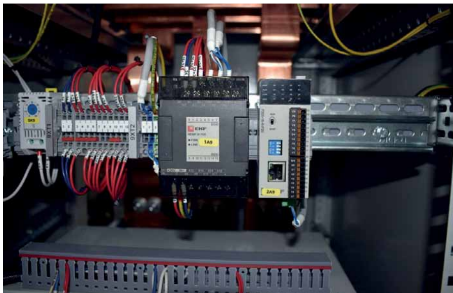
Рис. 2. Щит автоматизации систем энергоснабжения в исследовательском центре
