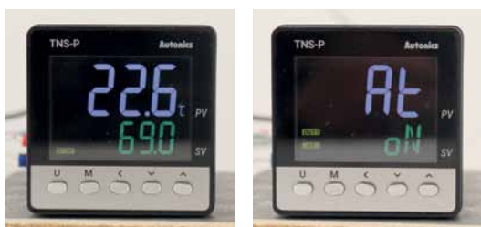
Выставляем первую уставку, выполняем автонастройку
