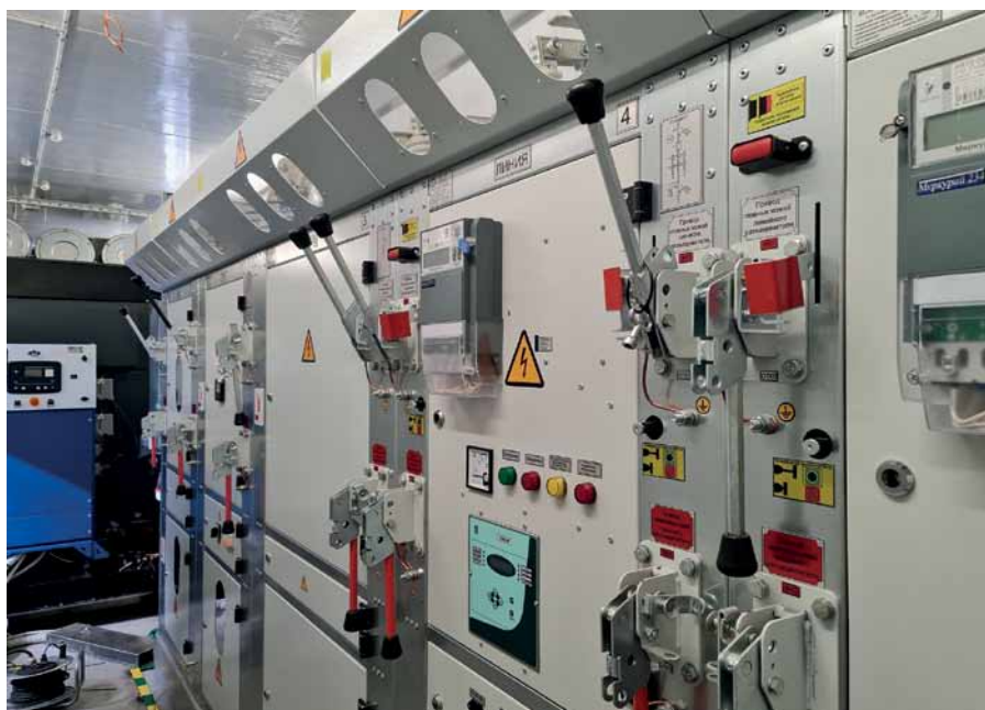
Рис. 4. Внутреннее пространство блок-контейнера: слева видна лицевая панель контроллера DSE 8610
