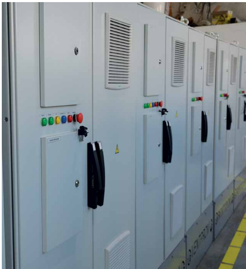
Рис. 3. Шкафы управления вентиляцией
