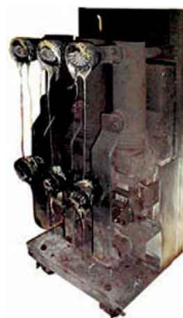
Рис. 3. Вакуумный автоматический выключатель, пострадавший из-за дугового разряда
