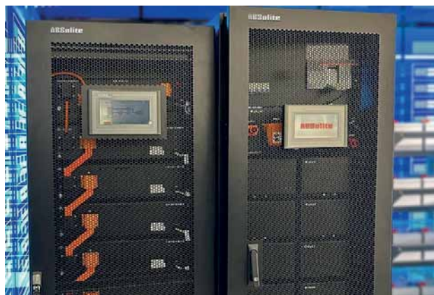
Рис. 3. Модули АКБ смонтированы в 19-дюймовых стойках
