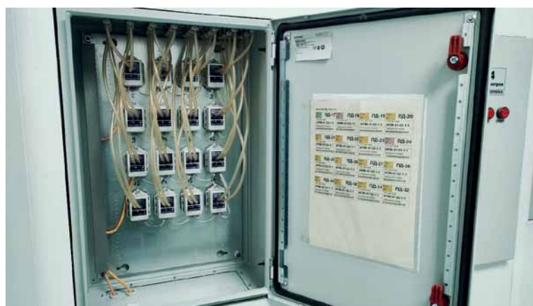
Рис. 4. Шкаф с датчиками перепада давления ИПМ-41-03-1
