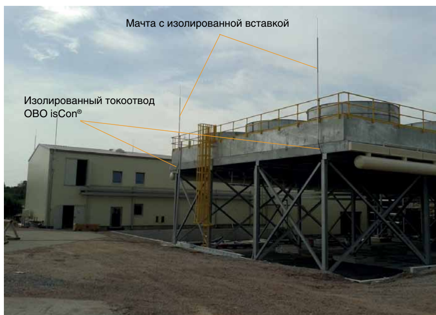
Рис. 3. Пример использования молниеприемных мачт с изолированными вставками и токоотводами OBO isCon® на промышленном объекте
