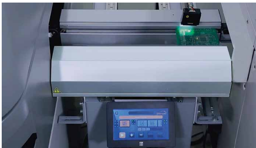
Рис. 2. Контроллер «Диполь СПУТНИК», установленный в конвейер
