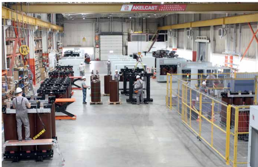
Рис. 1. Производство компании «АКЭЛ»: цех сборки трансформаторов
