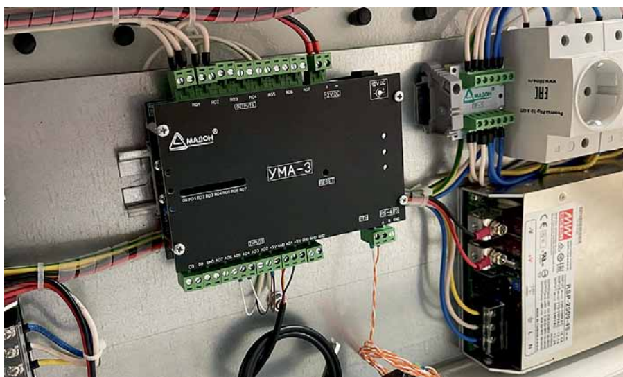
Рис. 2. Устройство мониторинга УМА, установленное в шкафу
