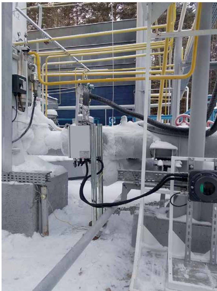
Рис. 1. Комплекс для анализа СПГ на ГРС-4 в ООО «Газпром трансгаз Екатеринбург»
