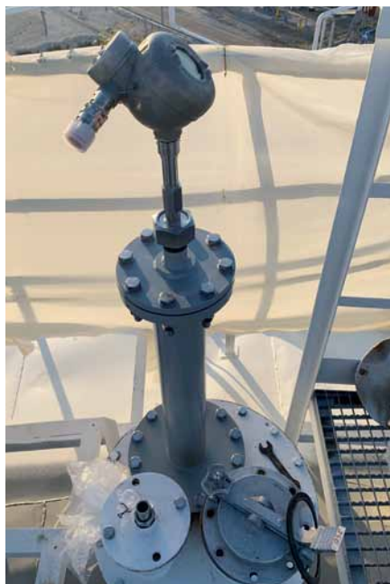
Рис. 4. Уровнемер РДУЗ-40 на фланце патрубка резервуара
