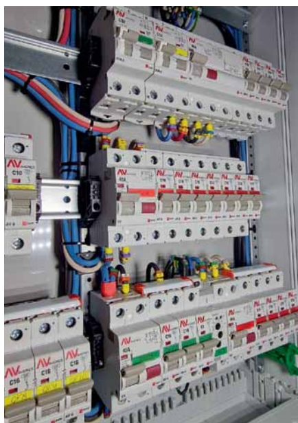
Рис. 6. Главный распределительный щит на оборудовании AVERES
