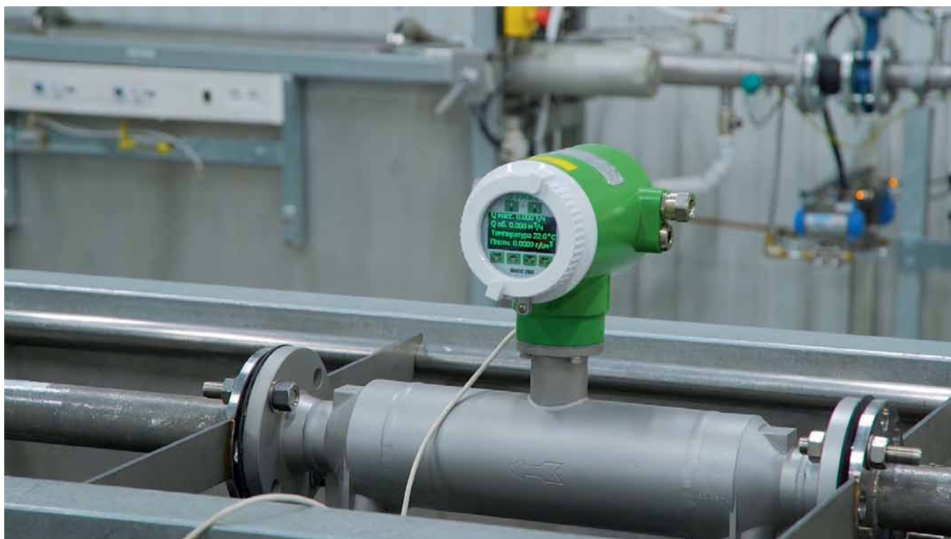
Рис. 1. Кориолисовый счетчик-расходомер «ЭМИС-МАСС 260» на трубе
