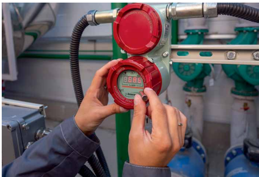
Рис. 6. Настройка стационарного датчика
