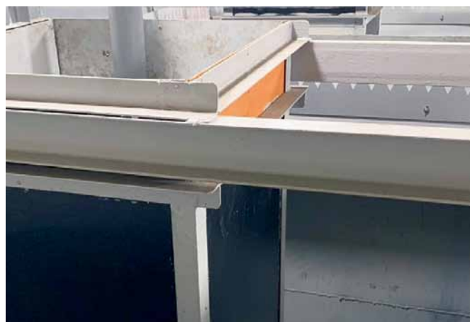
Рис. 4. Оборудование очистной станции, обработанное составом класса ZINKER
