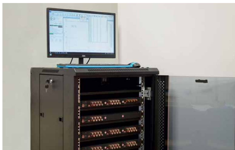
Рис. 4. Система, установленная в стойку 19 дюймов
