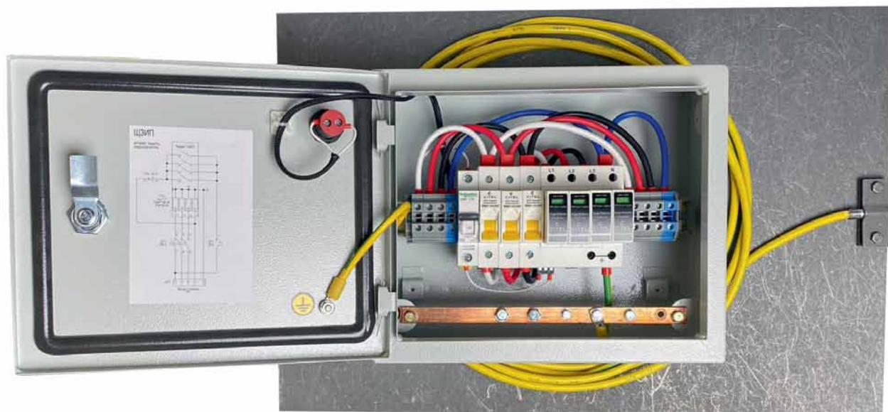
Рис. 2. ЩЗИП и мобильное заземление
