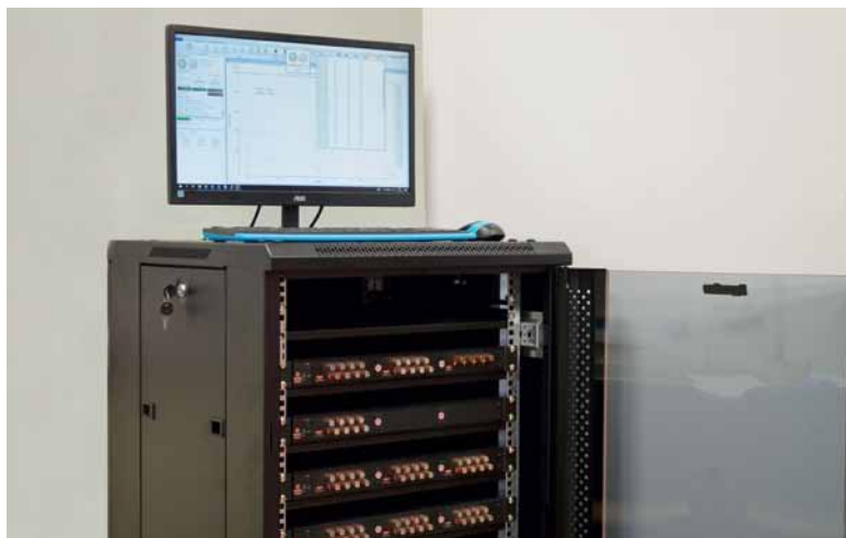
Рис. 4. Система, установленная в стойку 19 дюймов
