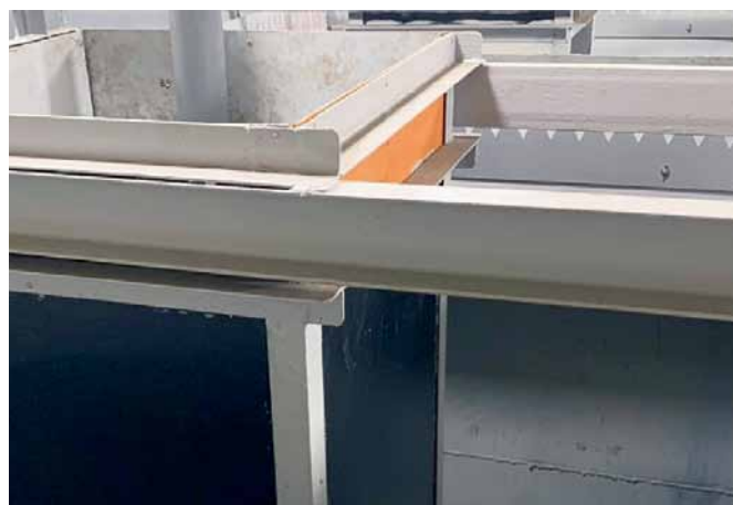
Рис. 4. Оборудование очистной станции, обработанное составом класса ZINKER
