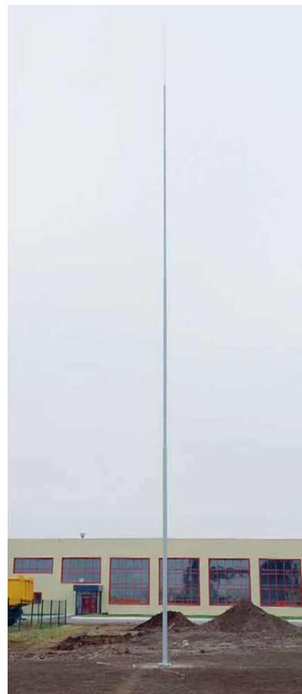
Рис. 1. Молниеотвод: отдельно стоящая мачта на бетонированном основании
