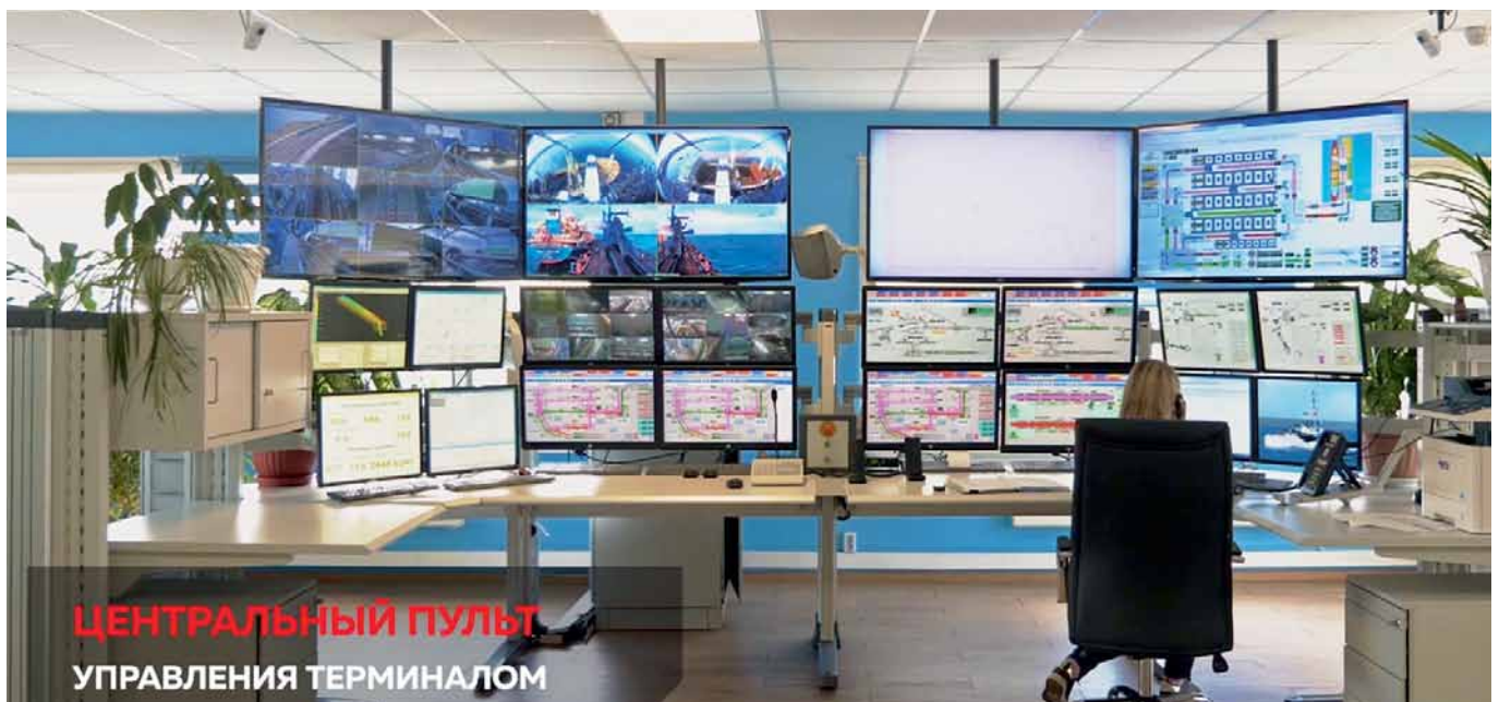
Рис. 1. Общий вид рабочего места оператора ЦПУ
