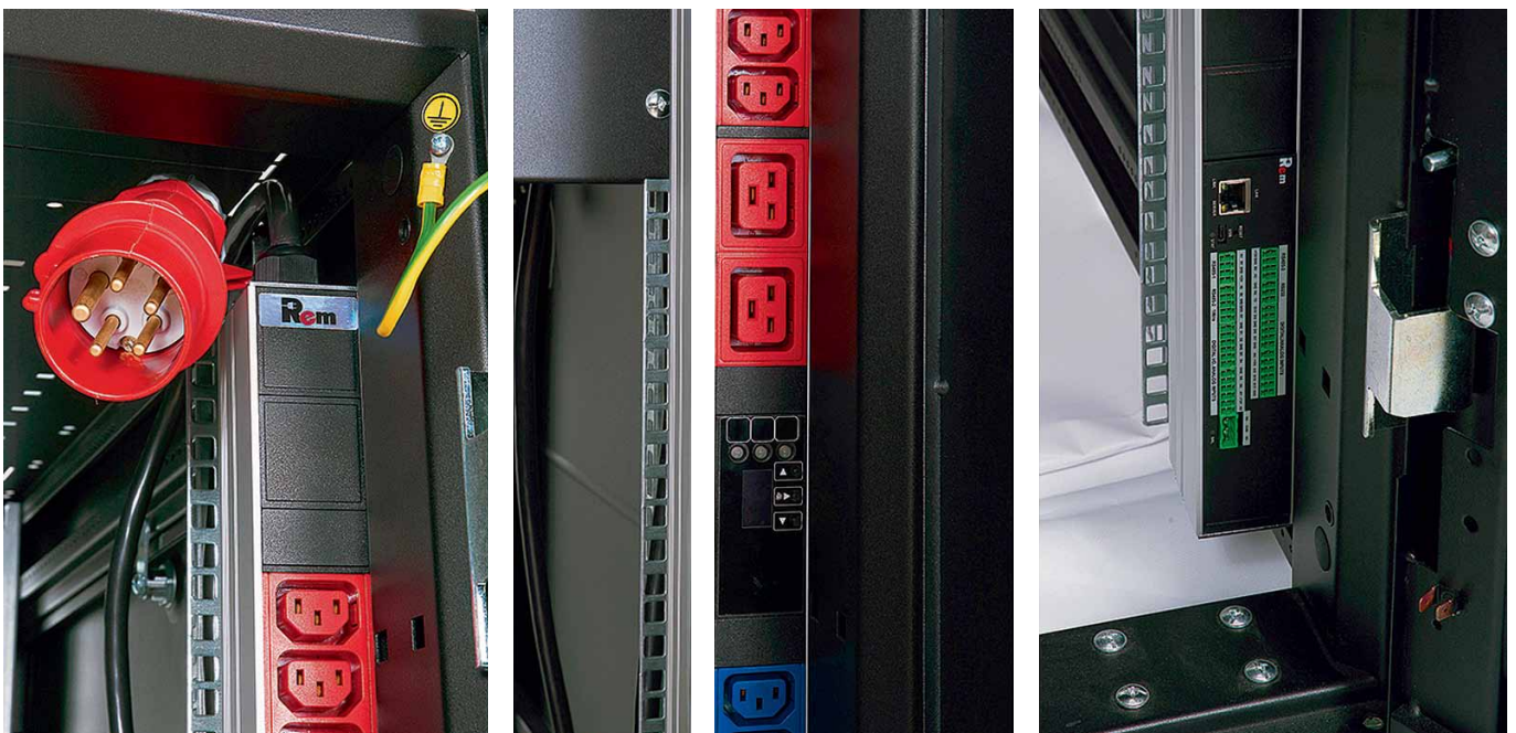
Рис. 3. Интеллектуальный блок питания REM-MS-MI, установленный в шкафу
