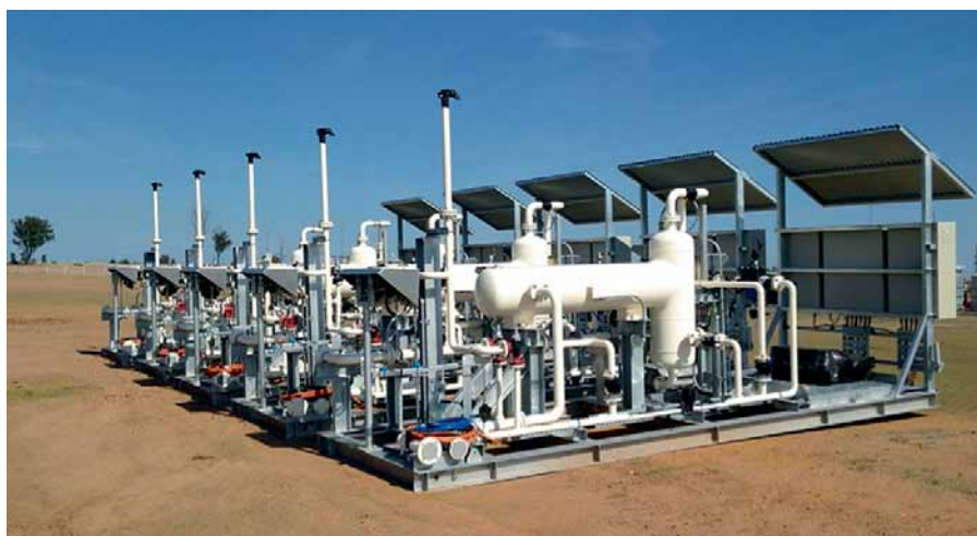
Рис. 1. Кустовая площадка с оборудованием системы электропитания на солнечных батареях
