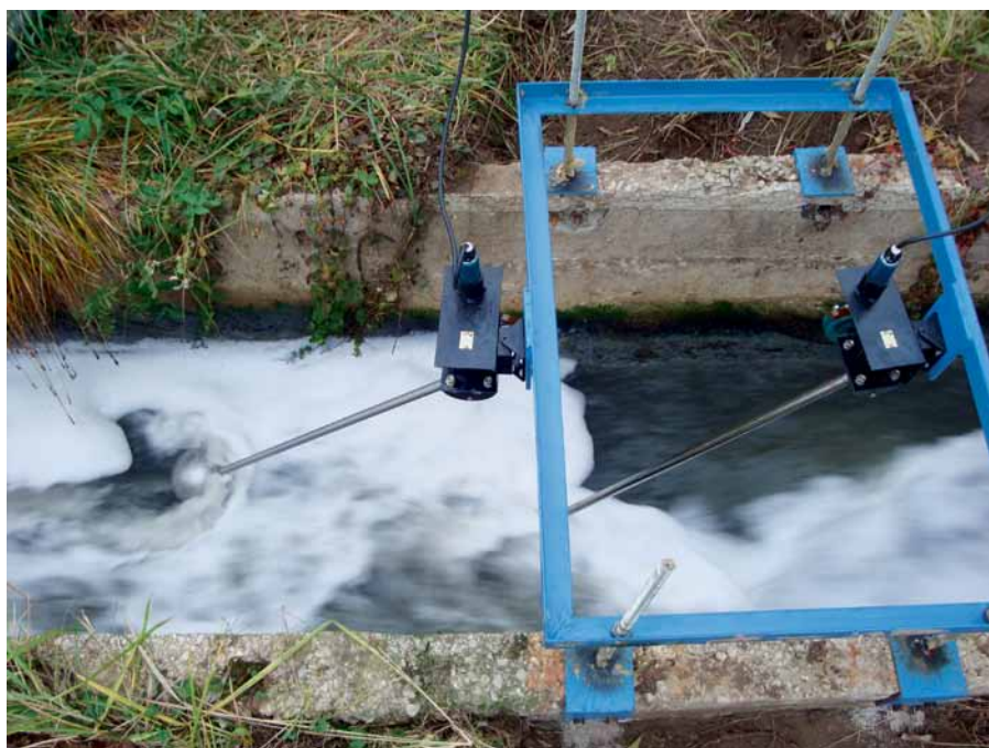
Рис. 2. Расходомер-счетчик «СТРИМ», установленный в турбулентном потоке
