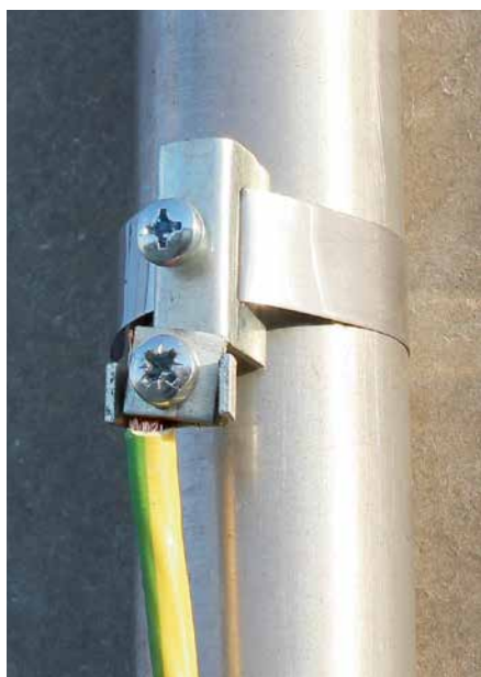
Рис. 2. Хомут для заземления, установленный на трубе
