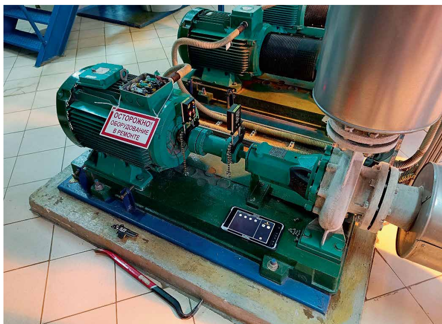
Рис. 2. Отключенный насос с установленными измерительными блоками VIBRO-LASER
