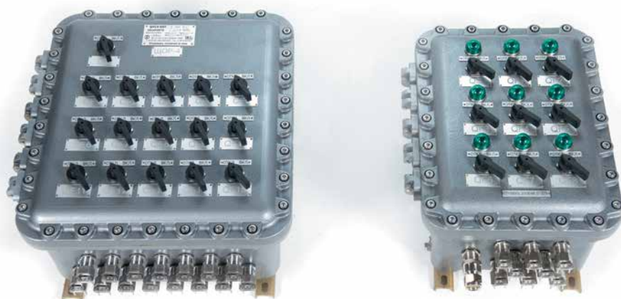
Рис. 5. Взрывозащищенный шкаф управления и сигнализации ШУС-ВЭЛ
