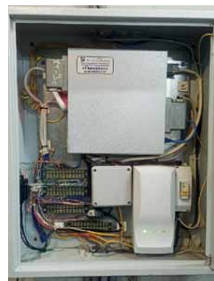
Рис. 4. Шкаф оборудования диспетчерского контроля лифта
