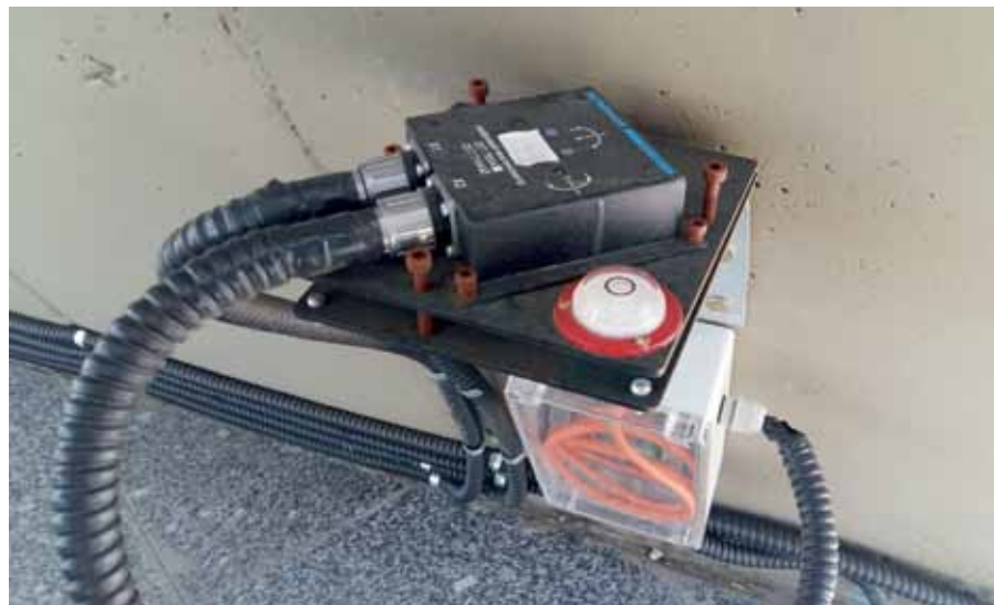
Рис. 1. Инклинометр, установленный на объекте
