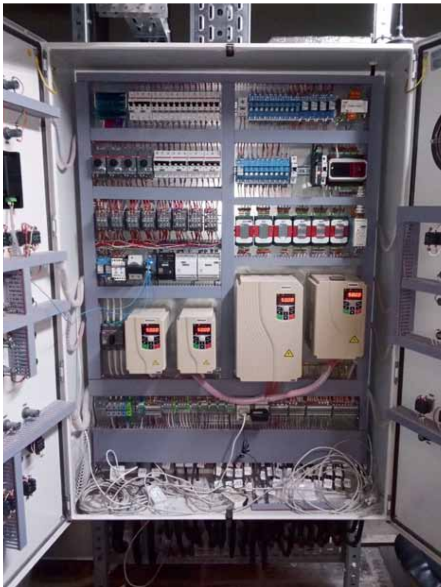
Рис. 1. Внешний вид шкафа автоматизации ЦТП (Мироновская ул., 33)
