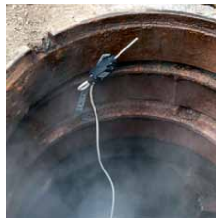
Рис. 7. Дополнительное подключение к модему PROMODEM GSM-125.00М датчика открытия люка PROMODEM 942.12: надежный рабочий ход удлиненного пружинного триггера исключает ложные срабатывания при проезде машин или неаккуратном монтаже люка
