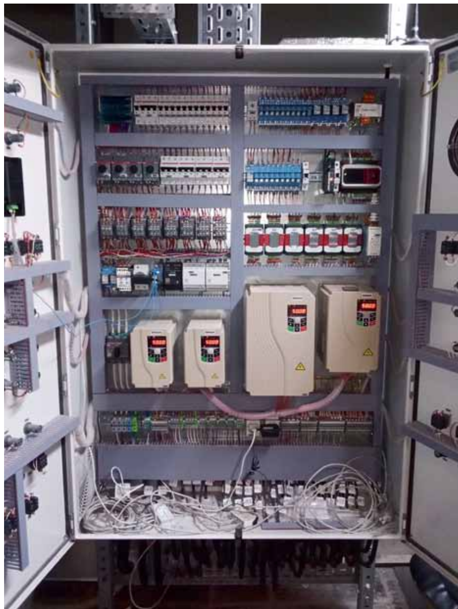
Рис. 1. Внешний вид шкафа автоматизации ЦТП (Мироновская ул., 33)
