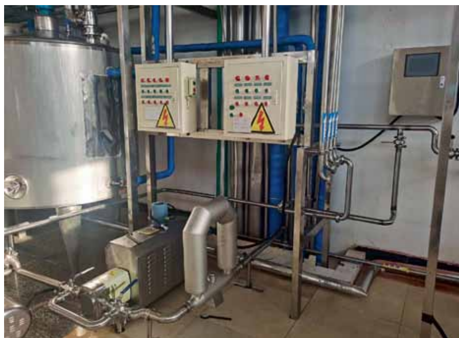
Рис. 2. Пример расположения расходомера YOKE YK-MFU на измерительном участке
