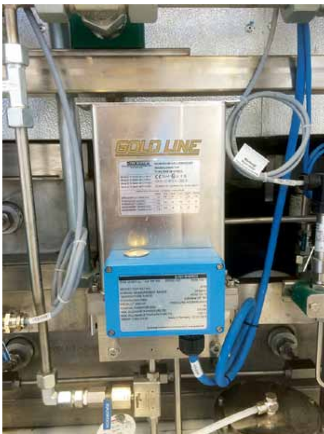
Рис. 2. Кориолисовый расходомер RHEONIK на станции заправки водородом
