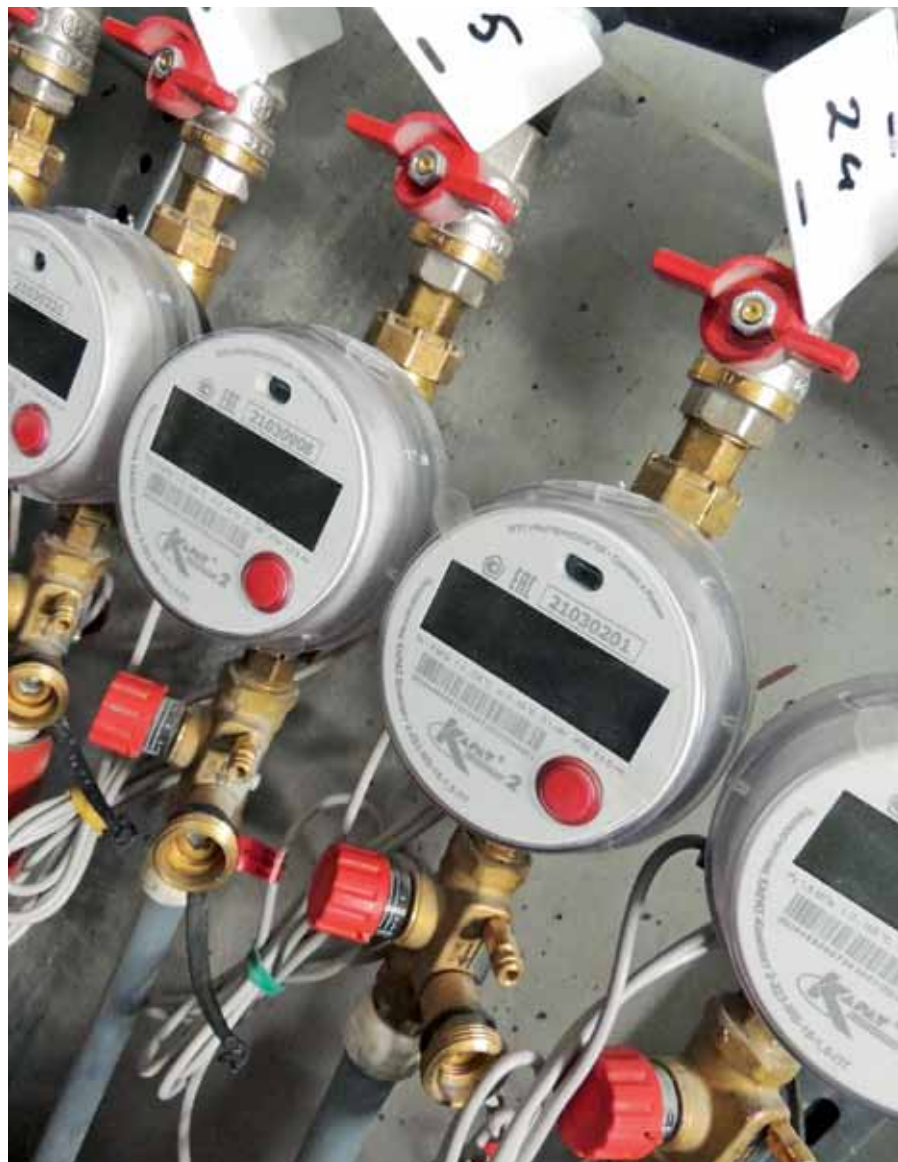
Рис. 3. Квартирные теплосчетчики KARAT-Компакт-223, установленные на стадии строительства
