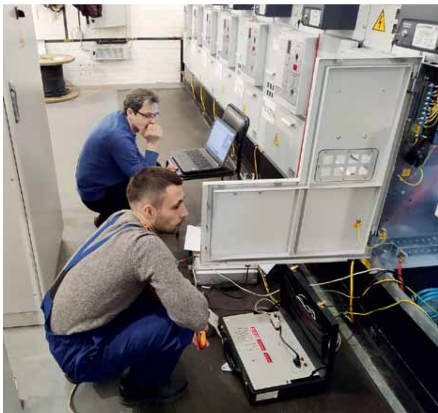
Рис. 4. Процесс калибровки устройства определения поврежденного фидера «НЕВА-ОПФ»
