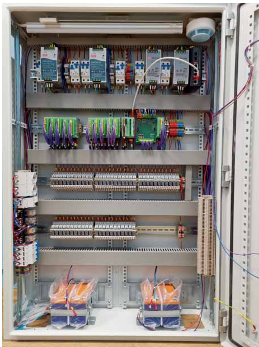
Рис. 1. Готовый шкаф с оборудованием – элемент управляющего комплекса «УМИКОН»
