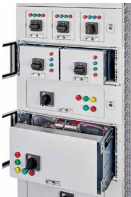
Рис. 1. Шкаф Rittal с выкатными ячейками
