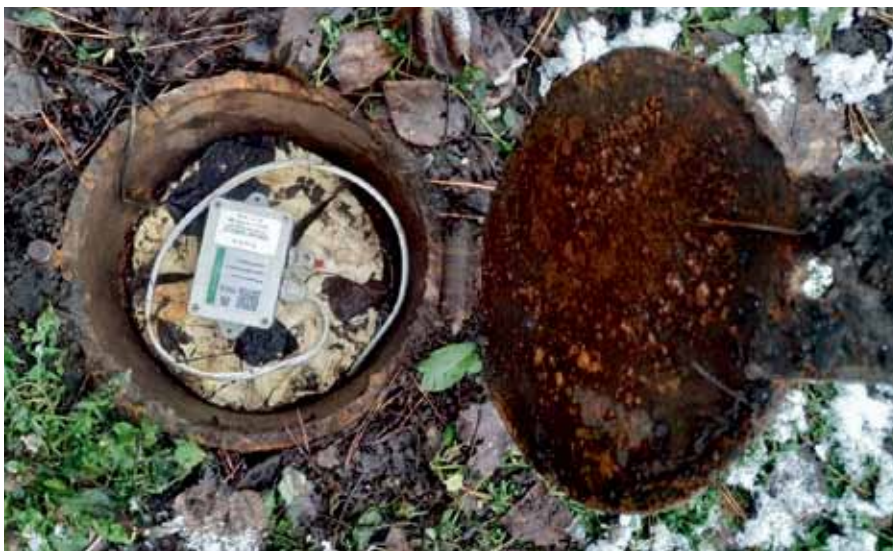
Рис. 8. Выносной узел контроля затопления тепловой камеры на базе комплекта «Датчик вскрытия люка и уровня-протечки PROMODEM GSM 830.04»
