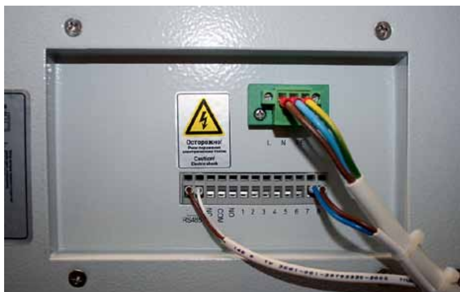
Рис. 5. Подключенный к системе мониторинга кондиционер
