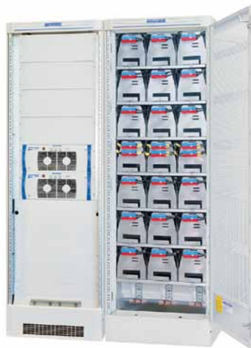
Рис. 8. «Кассетное» размещение аккумуляторных батарей в шкафу ИБП
