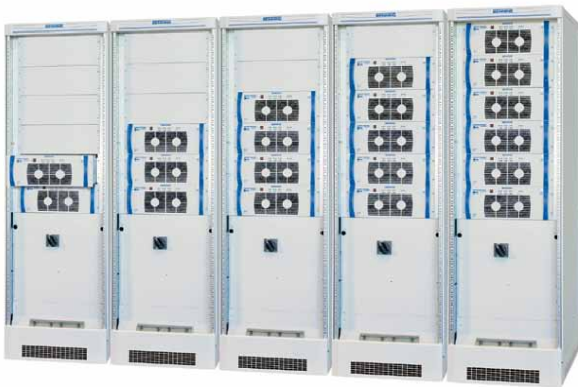
Рис. 5. Нарращивание мощности ИБП по принципу «оплата по мере роста»
